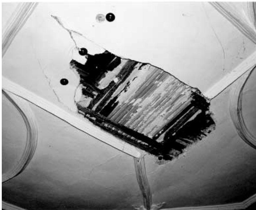
De schade leek onherstelbaar
