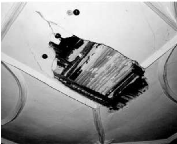
De schade leek onherstelbaar
